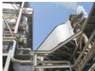
上海上电漕泾发电有限公司 1号机组低温省煤器。
